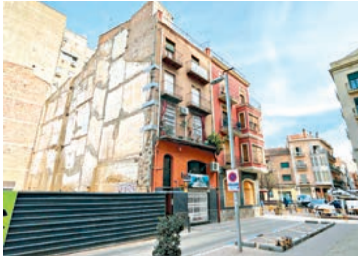
FOTO_ La Paeria Imatge de l'immoble desallotjat
